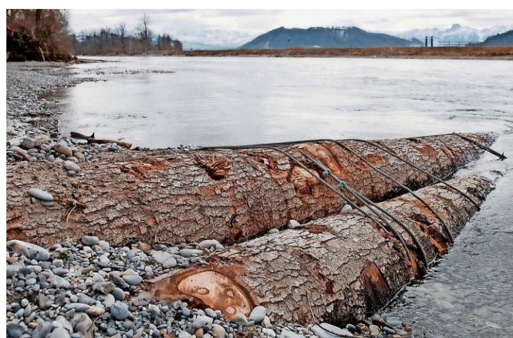
Die Baumstämme sollen den Uferweg vor Erosion schützen. Es ist und bleibt aber eine provisorische Lösung. Foto: Christian Pfander
